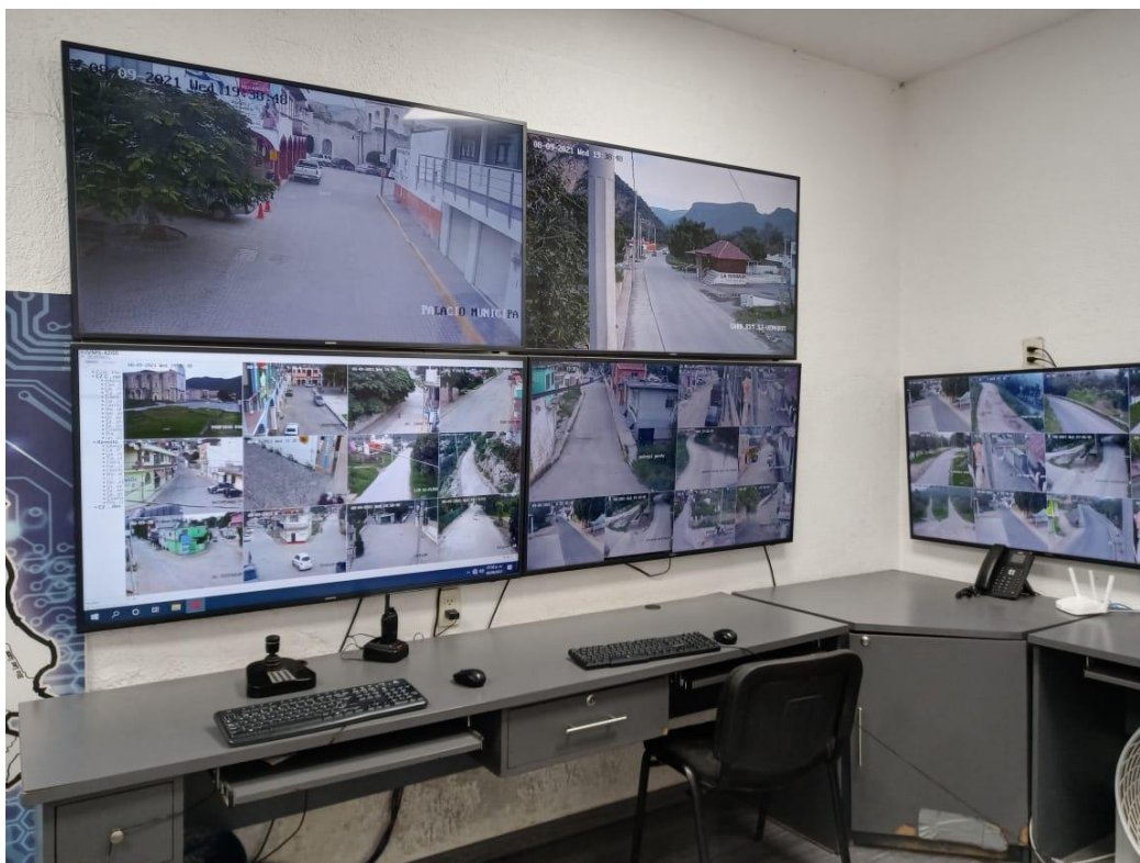
Imagen 11.- Centro de Control y Comando (C2).
