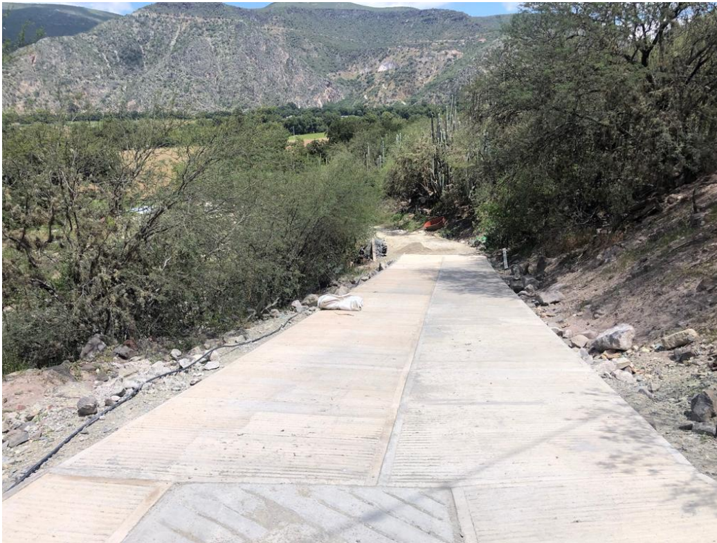
En la Comunidad de Cerro Partido con una inversión de $119,460.64 beneficiando a 18 habitantes de manera directa con 130.40 m2 de pavimento.
